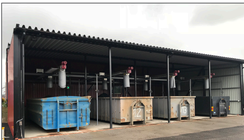
Foto: Skövde kommun, VA-verket
